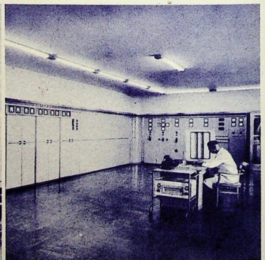
Bild 2. Der Stationsraum des neuen UKW-FM-Senders ist ausreichend groß, um weitere Sender aufnehmen zu können
